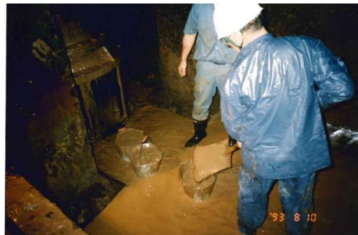
図3-6 浄水池に流入した土砂
