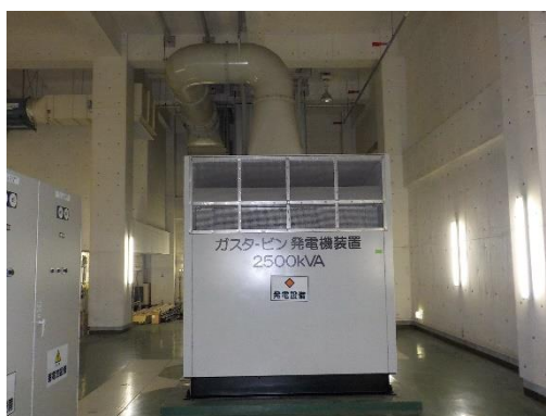
図3-10 河頭浄水場の非常用発電設備
