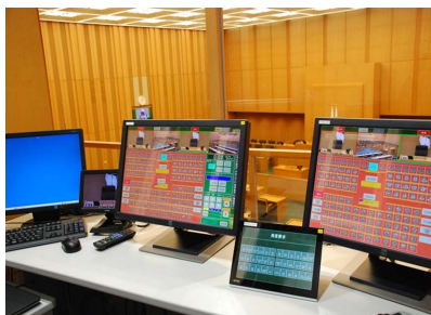
④操作室(議会録音機械室)
