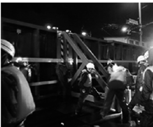
14年ぶりに閉鎖された大宮陸閘（岐阜市川原町地区）
