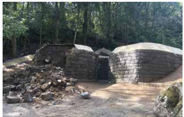
再崩落した石積 (令和5年3月)
