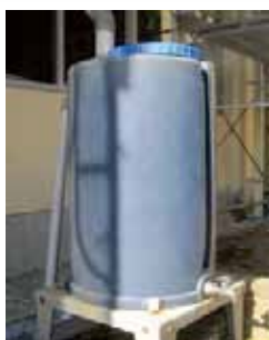
雨水タンクの利用
