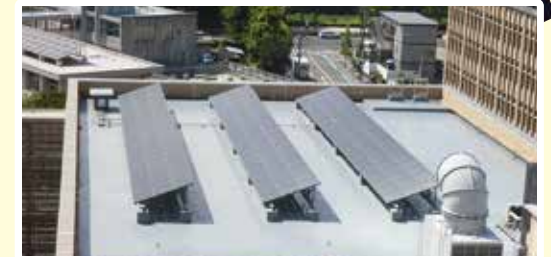
市役所本庁舎 別館の屋上には、太陽光発電が設置され、作られた電気は庁舎内で使用されています。
