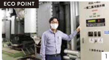
1.ガスコージェネレーションシステムの動力部。アミュの地下にこんな場所が！
