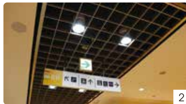
2.共用通路の照明は全てLED。フロアによって明るさや色味は工夫されている
