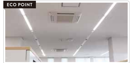
使っていない部分を消灯！
