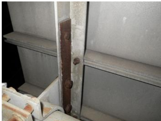
写5. 標識版取付部(腐食)
