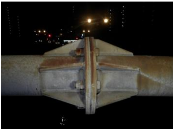
写4. 横張取付部(腐食)
