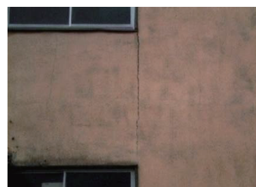
外壁の ひび割れ
