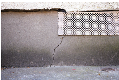
換気口付近の ひび割れ
