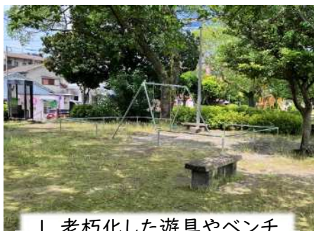
1. 老朽化した遊具やベンチ
