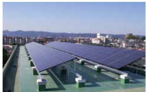
市有施設の太陽光発電システム
