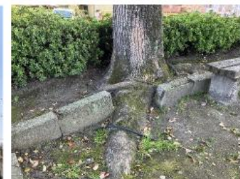
大木化した樹木の根がブロックを押し上げている様子
