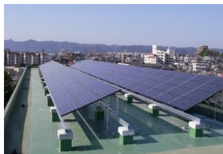
市有施設の太陽光発電システム
