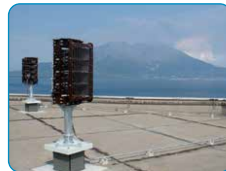
デジタル防災行政無線の整備
