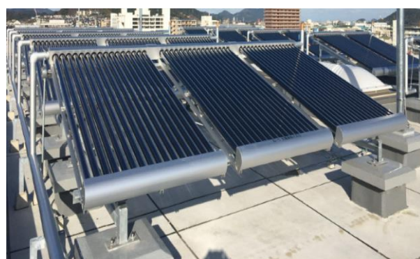
再生可能エネルギー（太陽熱）設置写真
