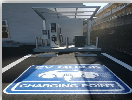
弊社全拠点に設置済みのEV用急速充電器
