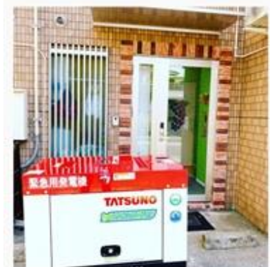
自然災害への備えとして緊急発電機を設置
