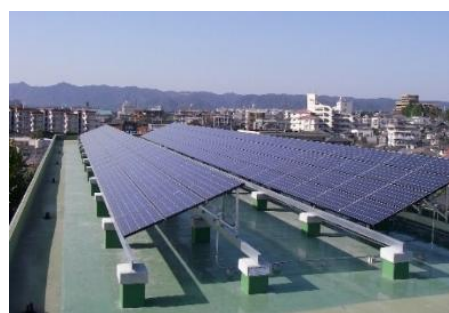
市有施設の太陽光発電システム
