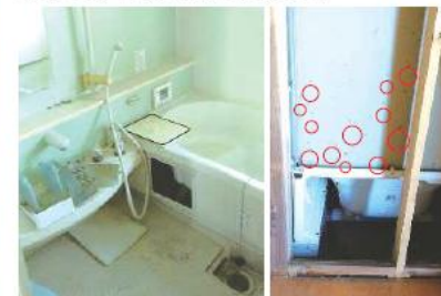
浸水したユニットバス 裏側に発生したカビ
