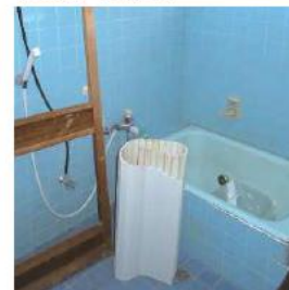
浸水した在来工法の浴室
