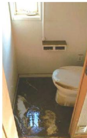
浸水したトイレの様子
