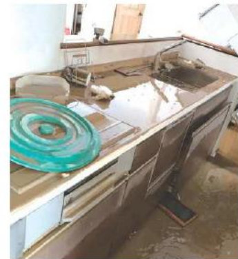
浸水したシステムキッチン
