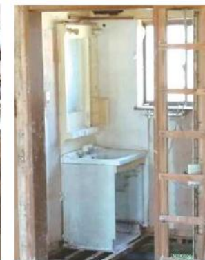
浸水後の洗面台
