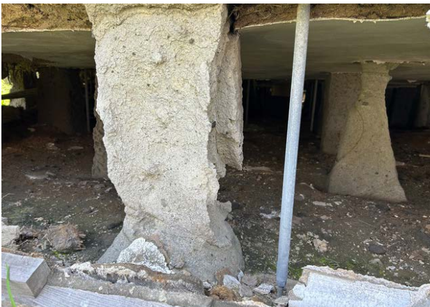
写真1 溶結凝灰岩の劣化
