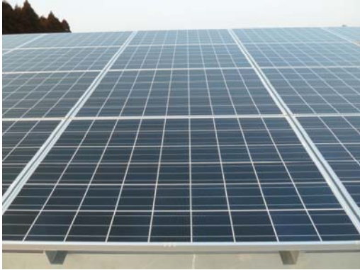
【太陽光パネル】
