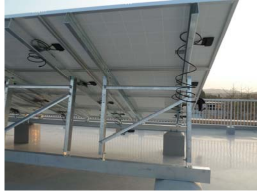
【太陽光パネル架台】
