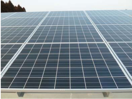
【太陽光パネル】
