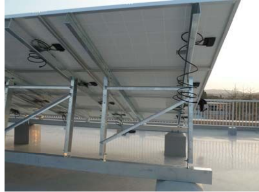
【太陽光パネル架台】
