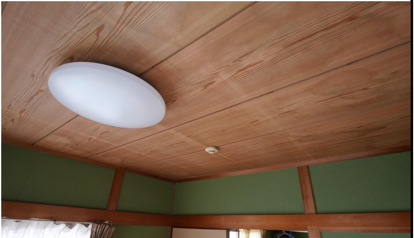
雨漏りの形跡（染み）あり（2階天井）
