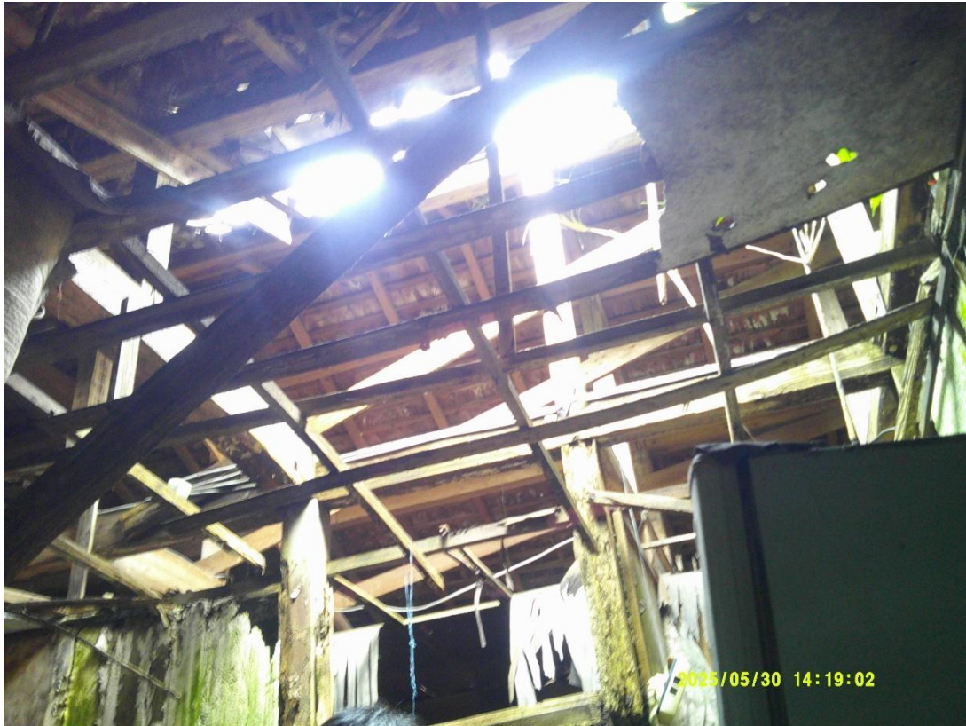
居宅の屋根部分が崩落している
