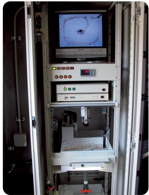
バイオアッセイによる水質監視設備
